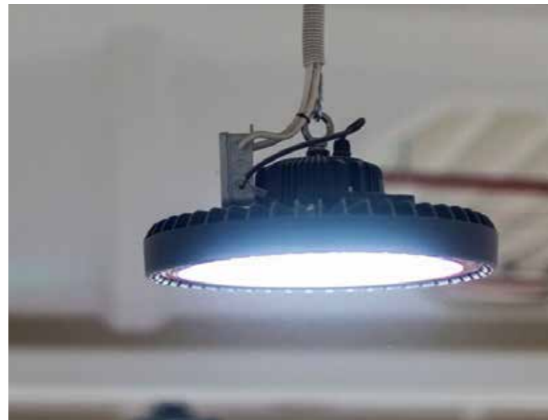
Die steuerbaren LED-Leuchten regeln die Leistung in Abhängigkeit vom Tageslicht
