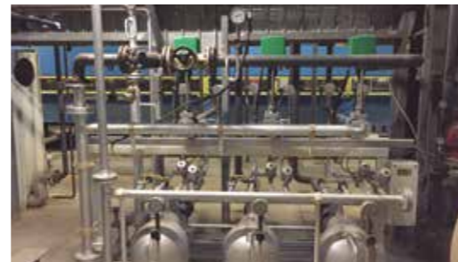
Weniger Energieverlust dank der neuen Kondensatheberstation in Moudon
